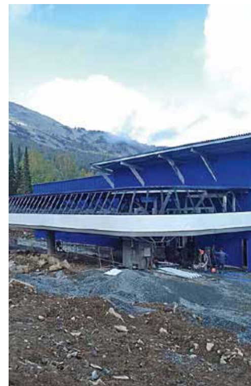
Im Skigebiet Sheregesh in Sibirien wurde im Jahre 2016 die abgetragene Flimjochbahn neu aufgestellt. Bild: Aufbau der Talstation.
